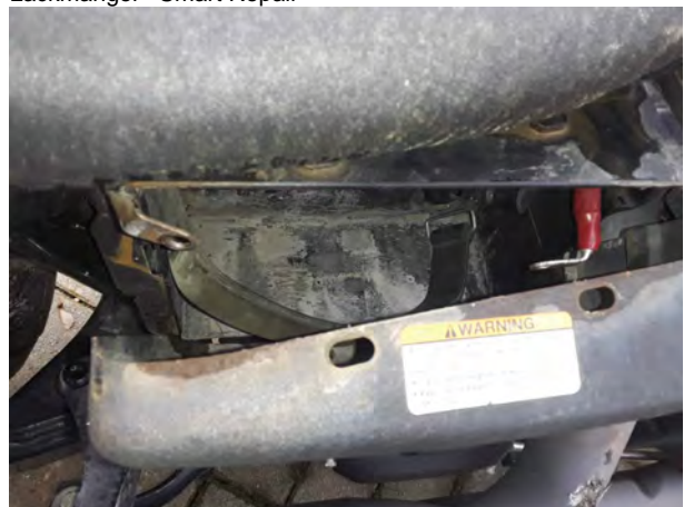
Beschädigung 4: elektrisches System: Batterie - fehlt - erneuern
